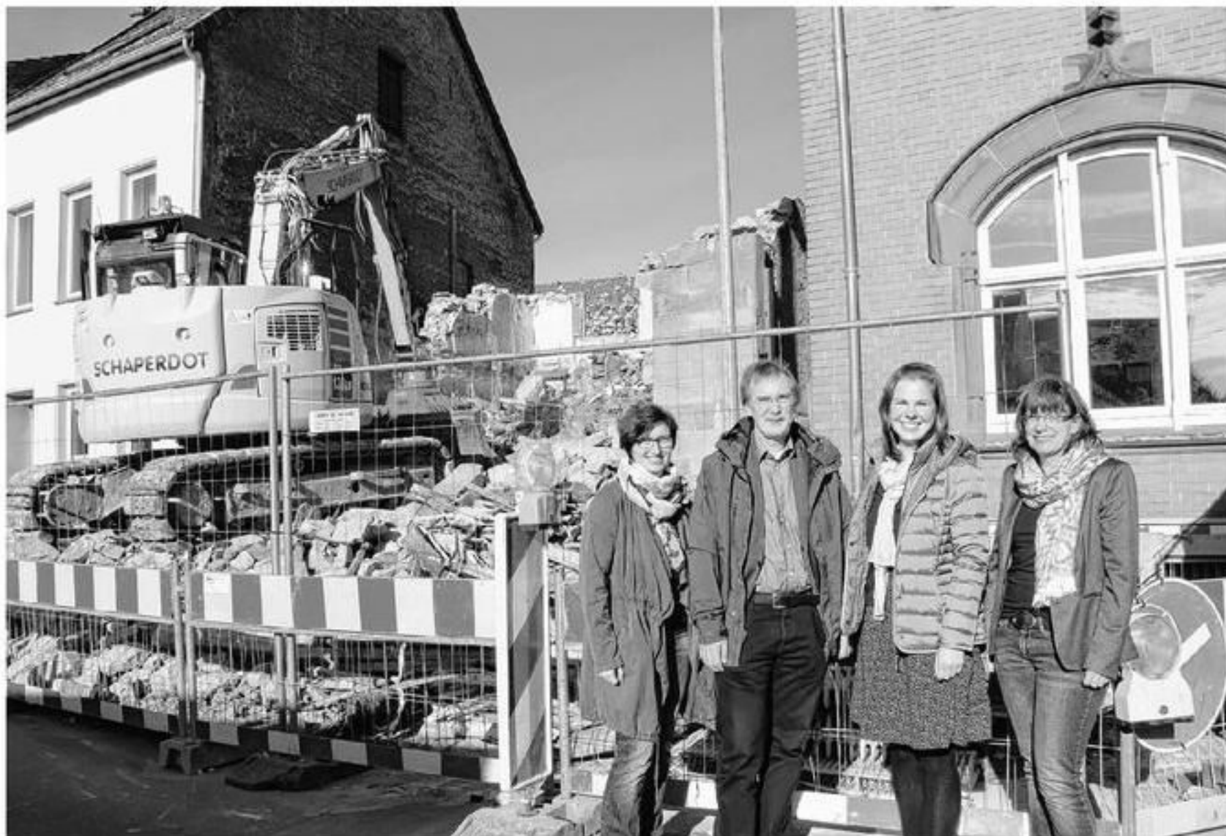
Die Arbeiten haben begonnen: Kindergartenleiterin Michaela Kregel, Eben-Ezer-Vorstand Udo Zippel, Helene Kriwoscheew vom Familienservice der Hochschule und Eben-Ezer-Bereichsleiterin Sabine Menzel (von links) als Zaungäste der Baustelle in der Stiftstraße.
