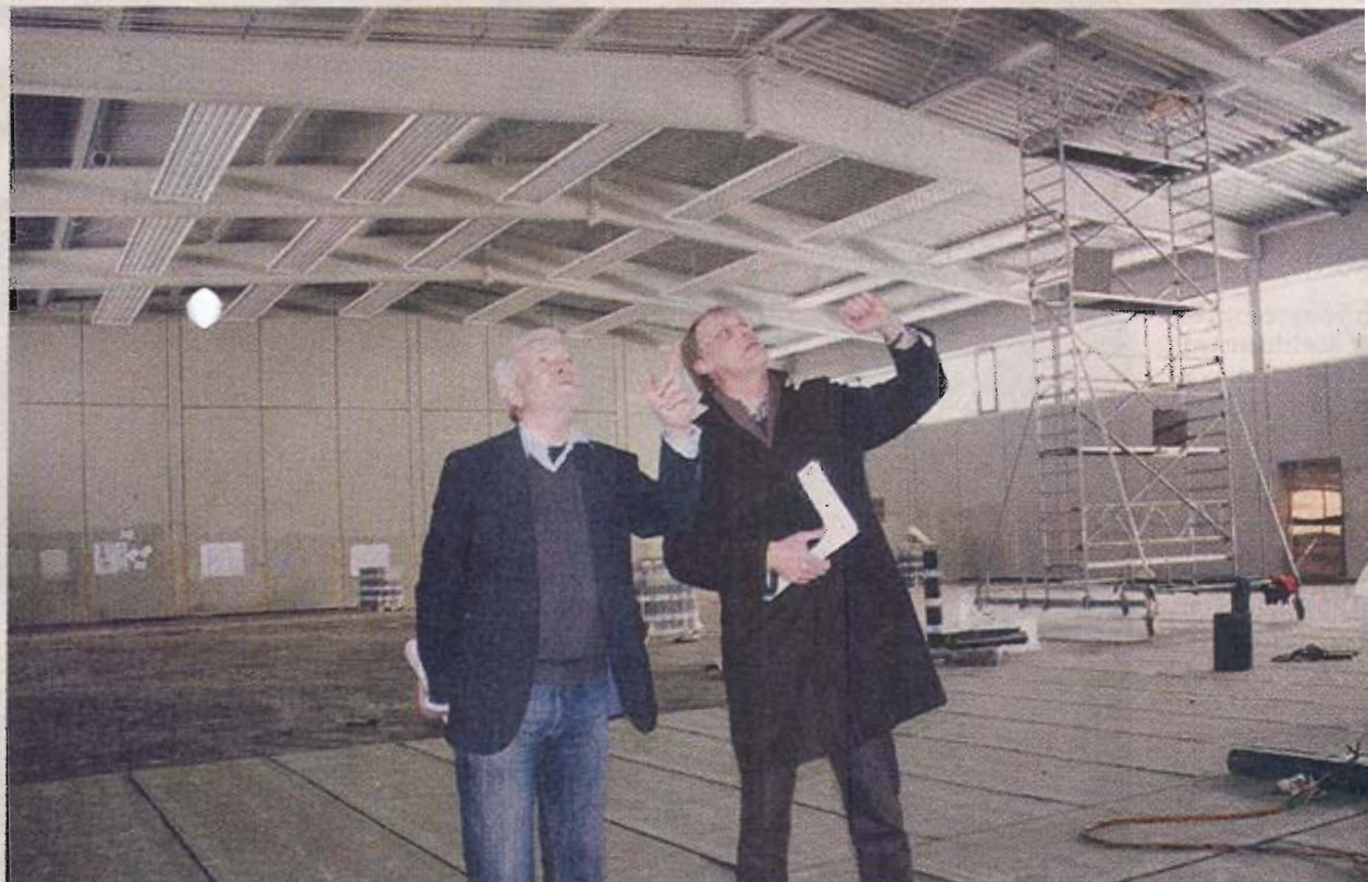
Blick nach oben: Bauleiter Claudius Wedepohl (Brand Architekten) erklärt Pastor Hermann Adam (links) das Heizungs- und Wärmeversorgungssystem der neuen Halle wird von der Decke aus mit Wärme versorgt.
